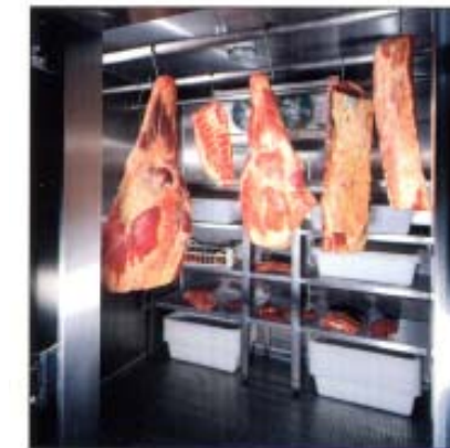
Cella di conservazione 0°C. Vid камеры для хранения 0°C.
