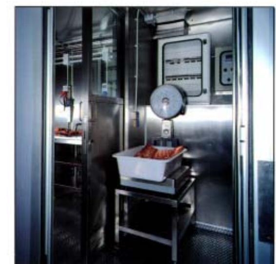
Atrio con quadri di comando. Vid переднего помещения / пульта управления.
